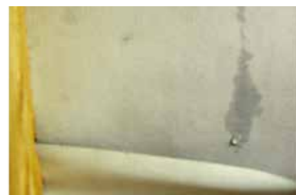
Poškození stěn v interiéru po vniknutí vody
