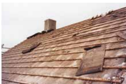
Zborcení konstrukce budovy působením hub a plísní
