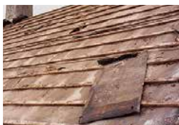
Zborcení konstrukce budovy působením hub a plísní
